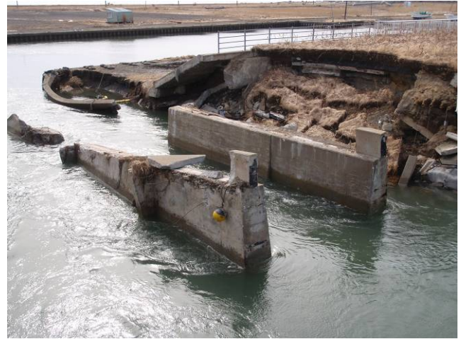
写真3 津波で破壊された旧汐見橋の橋脚（浜中町霧多布）
