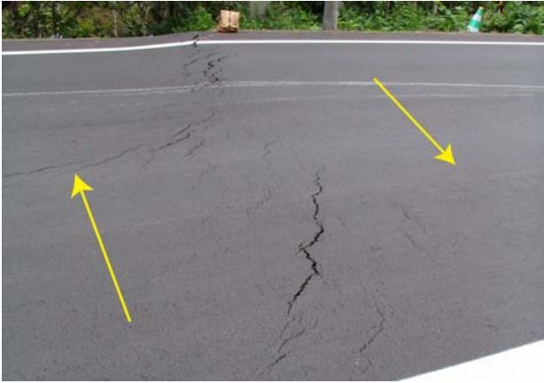
第3図 地すべり右側部の右横ズレを示す亀裂
