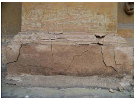
Obr. 3 Detail degradace omítek – diletantsky provedená ochrana proti zatékání
