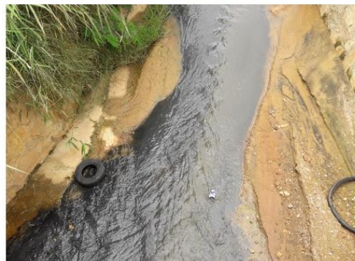
Poluição e assoreamento no canal do R. Jatobá - centro
