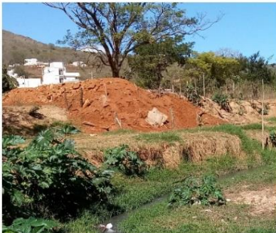
Entulho no leito para construção de ponte
