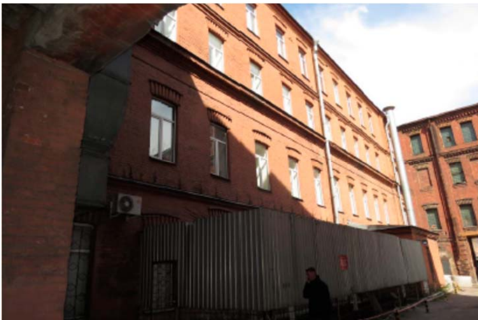
Фото 2. Южный фасад. Фрагмент. Окна первого этажа в границах проектирования закрыты чиллерной установкой.
