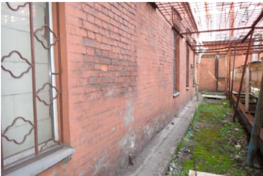
Фото 3. Фрагмент южного фасада за чиллерной установкой.
