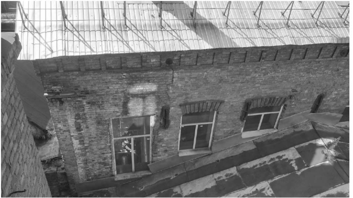
16. Комплекс товарищества Российско-американской резиновой мануфактуры «Треугольник» (80 производственных корпусов, соединенных переходами). Котельная. Штиглиц М.С. 17.11.2017 г.
