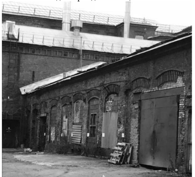
8. Комплекс товарищества Российско-американской резиновой мануфактуры «Треугольник» (80 производственных корпусов, соединенных переходами). Корпус №59. Северный фасад. Штиглиц М.С. 17.11.2017 г.
