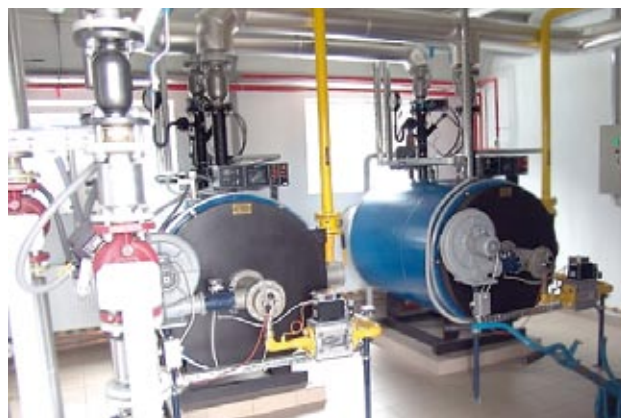
NOWA KOTŁOWNIA ZREALIZOWANA W CZĘŚCI TZW. „GÓRNICZEJ”
