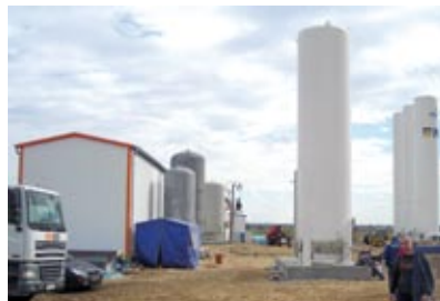
ZBIORNIK CIEKŁEGO AZOTU, ZBIORNIKI BUFOROWE HELU I POWIETRZA STEROWNICZEGO, W TLE ZBIORNIKI LNG
