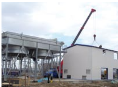
CHŁODNICE I KONTENERY KOMPRESORÓW METANU. UKŁAD TRZECH SPRĘŻAREK TŁOKOWYCH NAPĘDZANYCH SILNIKAMI GAZOWYMI O WYDAJNOŚCI 30 TYS. M 3 /H KAŻDA
