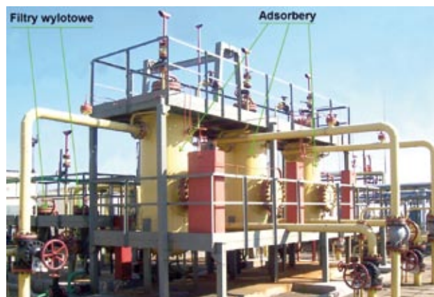
W ADSORBERACH RTĘĆ OSADZA SIĘ NA WARSTWIE WĘGLA AKTYWOWANEGO W POSTACI MIKROKROPEL I PARY. FILTRY WYLOTOWE MAJĄ ZA ZADANIE OCZYŚCIĆ GAZ Z EWENTUALNIE PORWANÝCH CZĄSTECZEK Z ADSORBERÓW.
