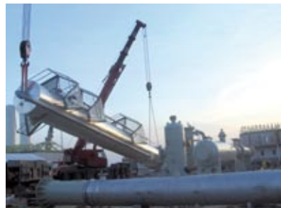
KOLUMNY ABSORPCYJNE NA AMINOWEJ INSTALACJI USUWANIA CO 2
