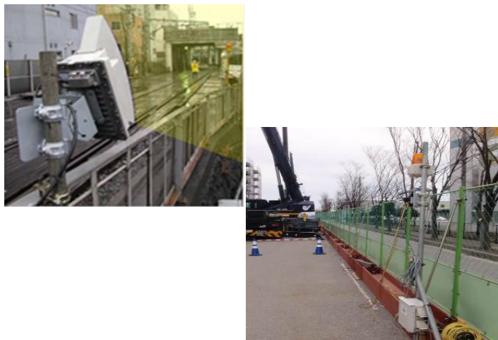
写真 5-12 レーザーバリア(空中越境監視装置)
