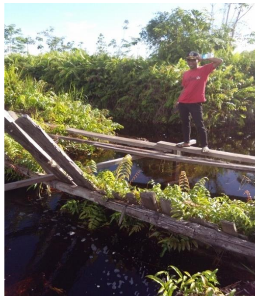
Skat Kanal di TR 1 yang sudah tidak berfungsi
