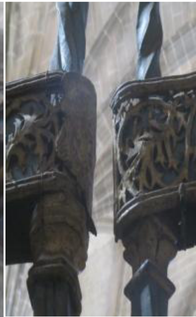
Fig. 11. Pérdida de simetría. (Similar a la Fig. 10). Ubicado en el lado opuesto de la reja.
