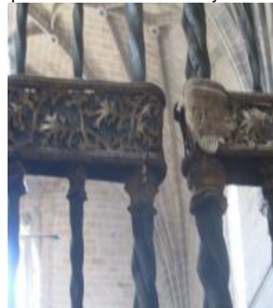
Fig. 4. Pérdida de la simetría que se encuentra actualmente en el coro. Parte del friso de la reja original del altar mayor.
