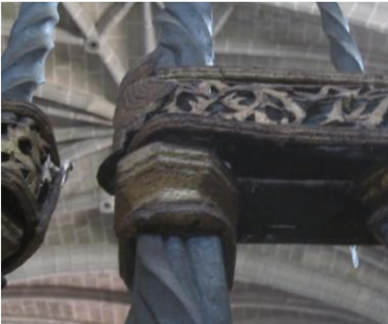
Fig. 10. Pérdida de simetría de las figuras. La parte derecha de la reja presenta una cabeza que debería estar presente en la parte izquierda de la puerta. En la imagen se puede apreciar el roleo del friso.
