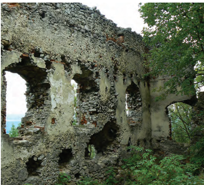
8. Palác západného predhradia, západná stena, stav pred a po obnove. Foto: Ján Barič.
