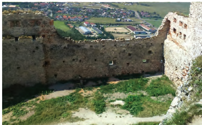
13. Juhozápadná časť južnej hradby, stav pred a po obnove. Foto: Ján Barič.
