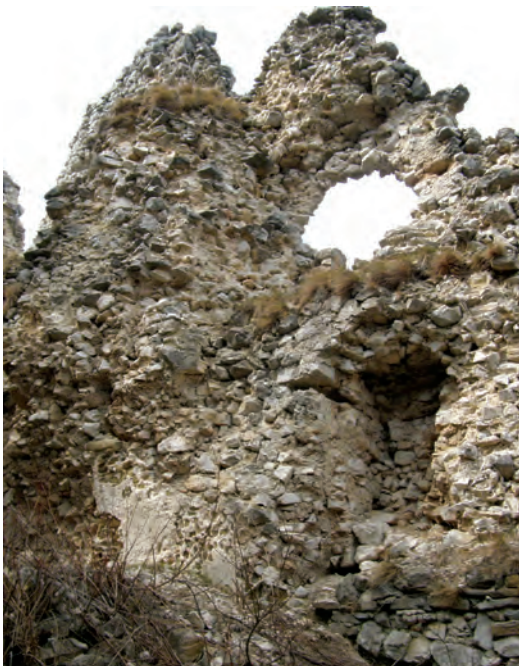
11. Detail časti múru paláca na hrade Blatnica. Havarijný stav je výsledkom rozpadu opakovane prestavaných otvorov a líca. Foto: Michal Šimkovic, 2010.
