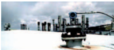
Rosemount серии 3300, установленный на резервуаре для отработанной соленой воды.
