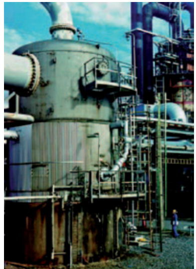
Продувочный сепаратор имеет высоту 8,5 м, но требуемый диапазон измерений составляет приблизительно 3 м, соответствующий максимально допустимому уровню наполнения, равному 3 м.
