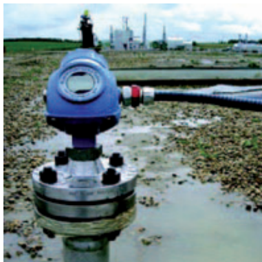
Rosemount серии 5400, смонтированный в успокоительном колодце. Антенна была обрезана по размеру трубы меньшего диаметра, установленной внутри
