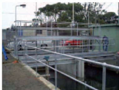
Рис. 1. Два уровнемера серии 3100, установленных в успокоительных колодцах диаметром 125 мм (5 дюймов), изготовленных из нержавеющей стали марки 316.
