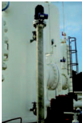
Поплавковый сигнализатор Mobrey DS20D и беспроводной преобразователь дискретных сигналов Rosemount 702, смонтированные на выносной камере.
