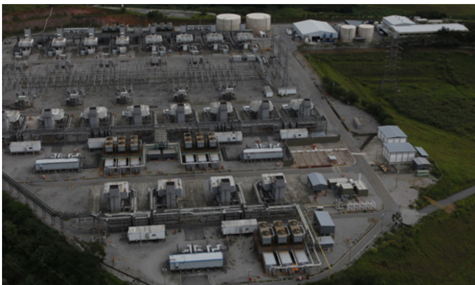
Figura 6 – Usina Mário Lago – Macaé, Rio de Janeiro. Fonte: Petrobras. Disponível em http://www.petrobras.com.br/data/files/66/92/A9/AC/03A954104F528454893851A8/mario_lago_termeletrica_Dig32526.jpg . Acesso em junho de 2016.
