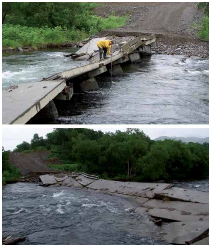
Рис. 3.5. Обрушение моста через р. Сарайную (бассейн р. Большой (Быстрой Малкинской), 2005 г.) (фото А.С. Чаловой)
