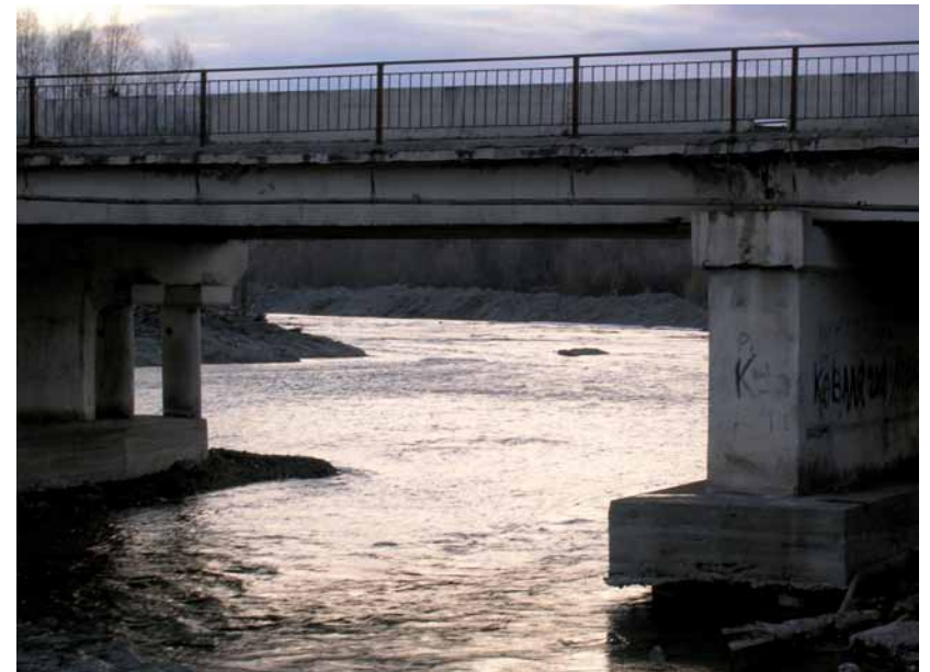
Рис. 3.4. Подмыв опоры мостового перехода на р. Андреановке автодороги Петропавловск-Камчатский — Мильково (фото С.Р. Чалова, май 2007 г.)
