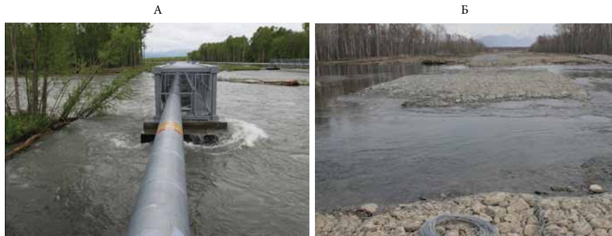
Рис. 3.46. Магистральный газопровод «УКПГ Нижне-Квакчикского ГКМ — АГРС г. Петропавловска-Камчатского» в створе пересечения через р. Авачу: наземный вариант (до 2012 г.) и подземный (после 2012 г.) (фото С.Р. Чалова)
