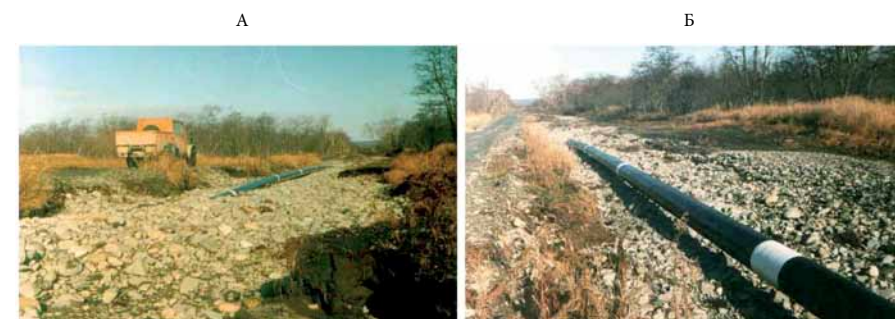
Рис. 3.14. Размыв дождевым паводком осенью 2002 г. завершённого траншейного перехода трубопровода через р. Мокушку (фото А.В. Улатова)
