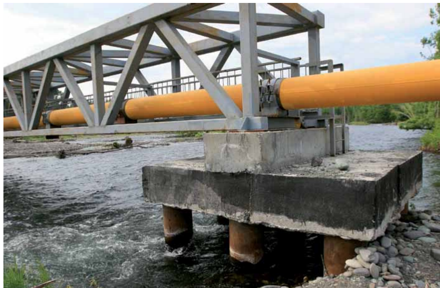
Рис. 3.43. Подмыв левого берега и бетонных оснований береговой опоры верхней фермы наземного перехода в первый год после строительства (фото А.С. Завадского)
