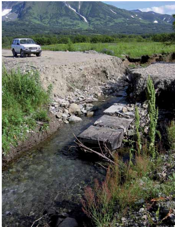
Рис. 3.8. Размыв дорожного полотна при неправильной установке водопропускного сооружения (бассейн р. Большой (Быстрой Малкинской), 2006 г.) (фото В.Н. Лемана)
