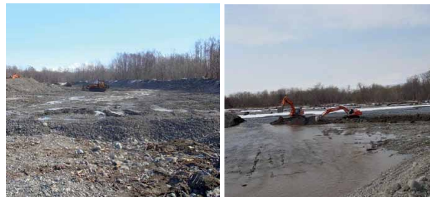
Рис. 3.59. Русловыправительные работы — апрель 2008 г. (из архива отдела Архитектуры и градостроительства Администрации Елизовского муниципального района)
