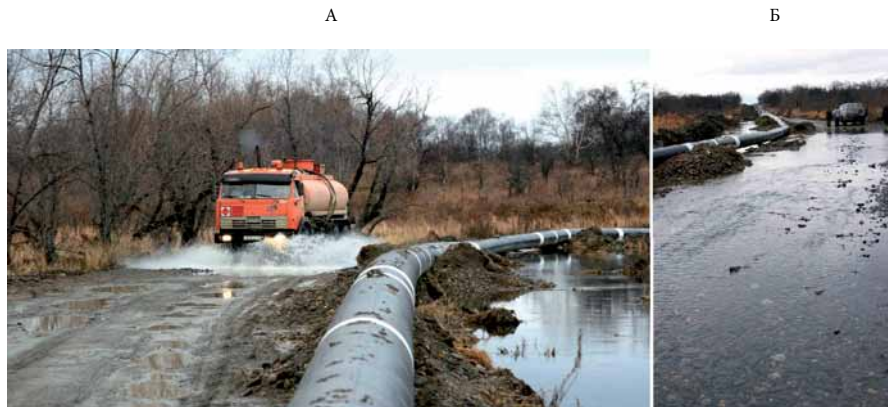
Рис. 3.17. Перелив водотока водой в октябре 2008 г. через притрассовый проезд в результате заполнения траншеи на ручье Куев 1-й (ПК 1749 + 70) — приток р. Правого Кихчика (басс. р. Кихчик) (фото А.В. Улатова)
