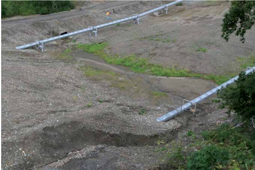
Рис. 3.15. Провис нитки газопровода через р. Колпакову в августе 2011 г. (фото А. В. Улатова)
