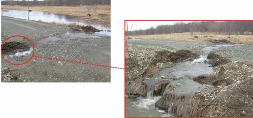
Рис. 3.7. Размыв дороги г. Петропавловск-Камчатский — с. Соболево (фото Е.В. Есина, август 2008 г.)
