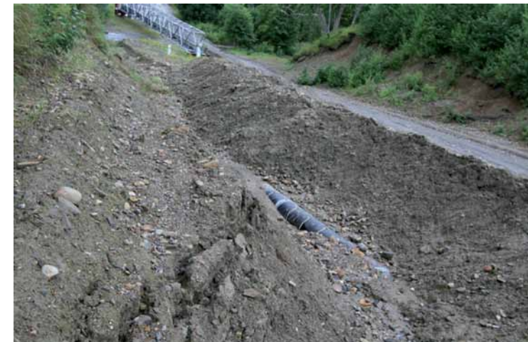
Рис. 3.19. Разрушение дорожного полотна автодороги вдоль трассы Камчатского МГ возле р. Соболиной (фото А.В. Улатова, август 2011 г.)
