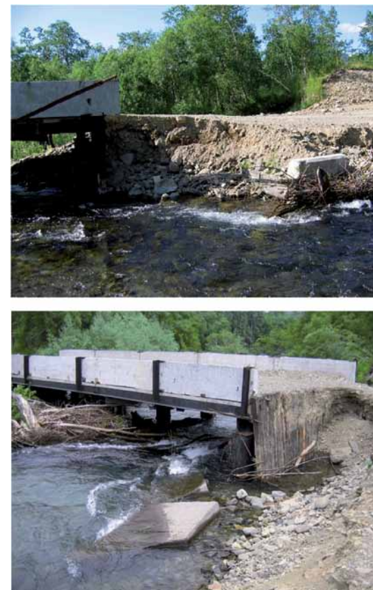
Рис. 3.6. Размыв моста при его установке в излучине реки (бассейн р. Большой (Быстрой Малкинской), 2006 г.) (фото В.Н. Лемана)
