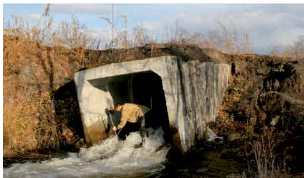
Рис. 3.9. Ошибочное строительство водопропускных сооружений. Типичные просчёты: малый диаметр трубы, неверный её уклон, в результате которого образовался искусственный порог между рекой и трубой (бассейн р. Авачи и р. Большой (Быстрой Малкинской)) (фото В.Н. Лемана)
