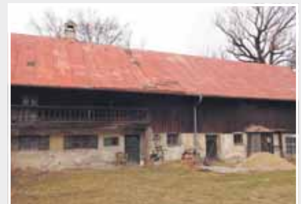
Der im Jahre 1751 erbaute Derzbachhof, ältester Bauernhof auf Münchner Stadtgebiet, soll saniert werden; für die Zukunft des Anwesens im Zentrum Forstenrieds sind unkonventionelle Wohnungen geplant. Foto: Hoffmann
