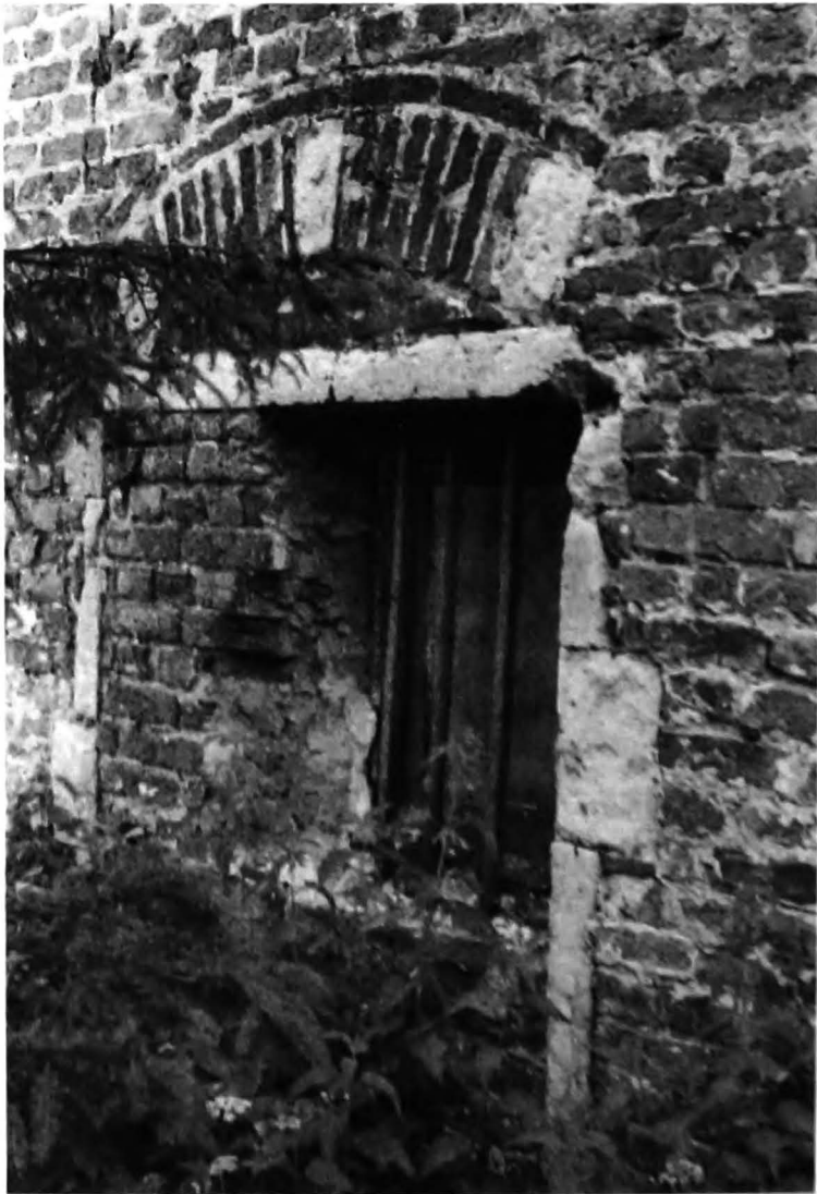
Een onlogische zandstenen omlijsting van een kelderraam. Het hangende linteel wijst duidelijk op verbouwing.
