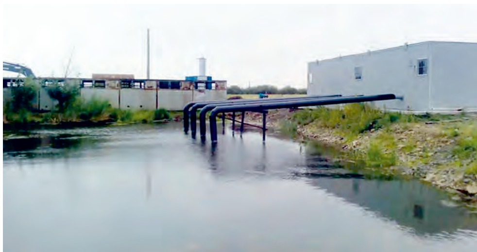
Рис. 2.25. Абзелиловская оросительная система (насосная станция) (Республика Башкортостан)
