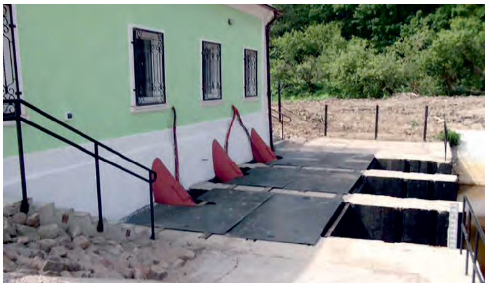
Рис. 2.18. Осушительная насосная станция № 13 (Калининградская область)
