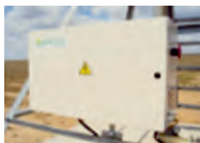
Центральный пульт управления
