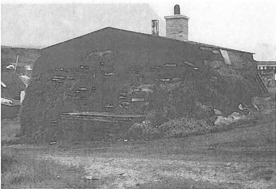
Det tidligere grøntsagshus fra 1950 er i forfald.
