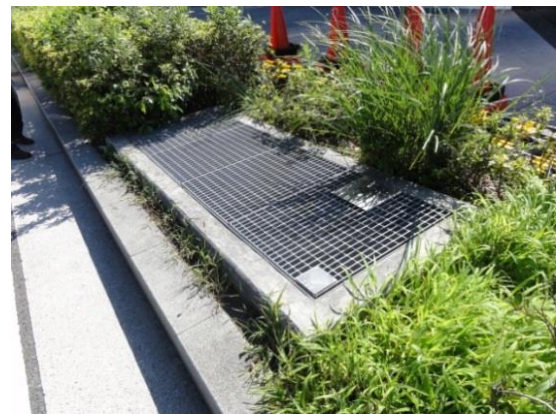
共同溝の換気口
