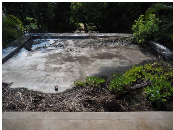
圖 4-18 玄關平台混凝土劣化
