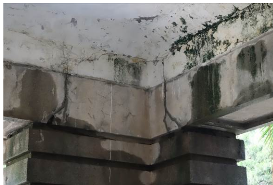
圖 5-28 植物附生致使牆體開裂
