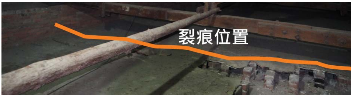
圖 4-2 [R09]與[R16]上方樓板裂縫
