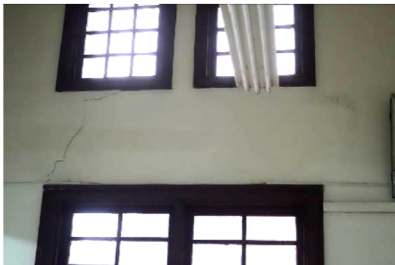
圖 5-31 開口部角隅斜向裂縫
