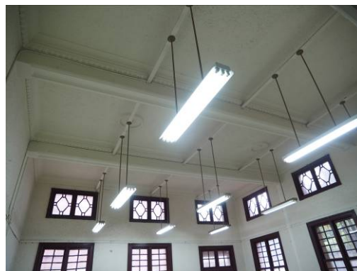
圖 3- 245 燈具線路採用明管架設
