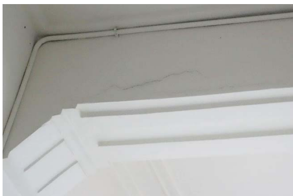
圖 5-15 RC 樓板樑開裂
