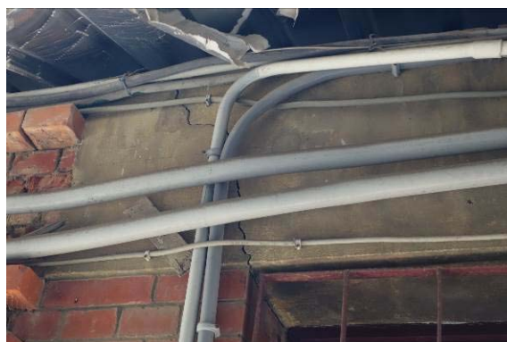
圖 5-36 開口部角隅斜向裂縫
