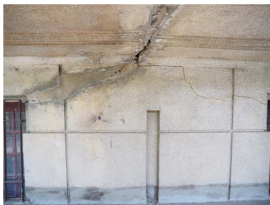
圖 4-6 [R09]與[R16]外牆裂縫
