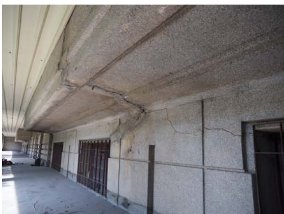
圖 4-5 [R09]與[R16]外牆裂縫
