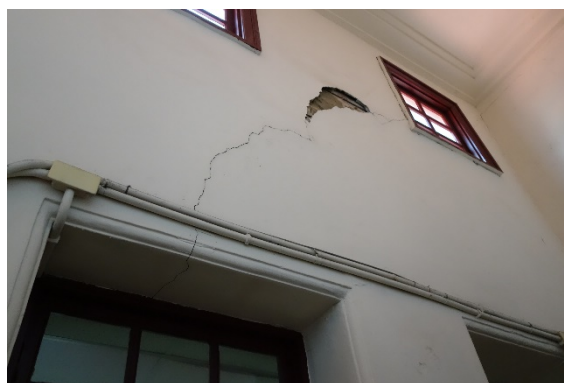
圖 5-43 與分期界面垂直牆體開口角隅斜向裂縫
