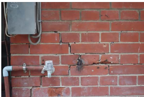
圖 5-19 固定鐵件鏽蝕造成之磚牆裂縫
