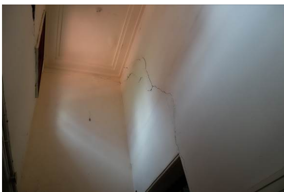
圖 5-44 與分期界面垂直牆體開口角隅斜向裂縫
