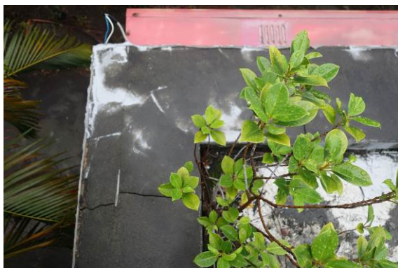
圖 5-27 植物附生致使牆體開裂
