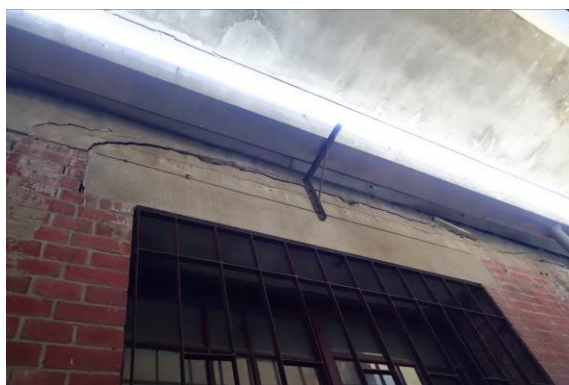
圖 5-23 角鋼鏽蝕造成之磚牆裂縫
