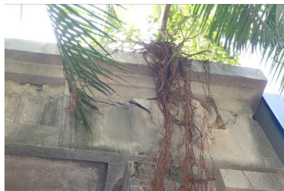
圖 5-29 植物附生致使 RC 樑、牆體開裂
