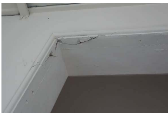
圖 5-17 RC 樓板樑開裂
