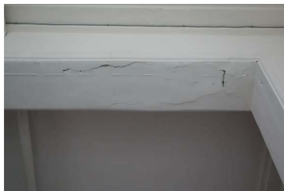
圖 5-16 RC 樓板樑開裂
