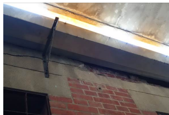
圖 5-24 角鋼鏽蝕造成之磚牆裂縫
