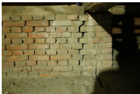
圖 5-45 分期界面 RC 頂版上方牆體垂直裂縫
