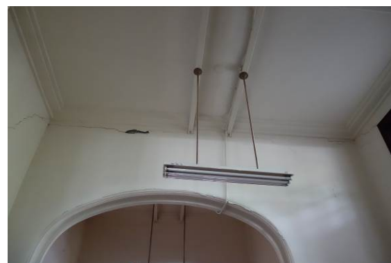
圖 5-41 分期界面牆體頂部水平裂縫
