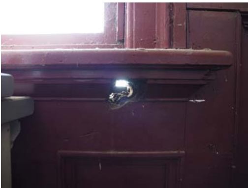
圖 4-26 室內裝修遭穿孔
