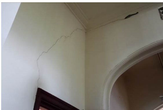
圖 5-40 與分期界面垂直牆體開口角隅斜向裂縫
