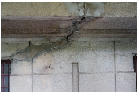
圖 5-38 與分期界面垂直牆體開口角隅斜向裂縫
