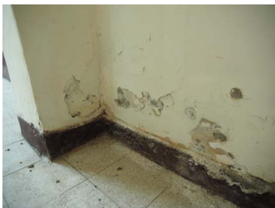
圖 4-22 室內漆喰剝落
