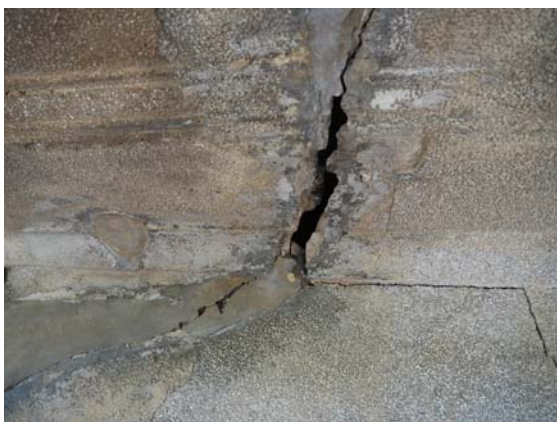
圖 4-7 [R09]與[R16]外牆裂縫細部
