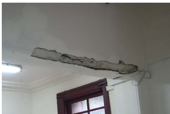
圖 5-18 RC 楣樑破損、鋼筋鏽蝕外露
