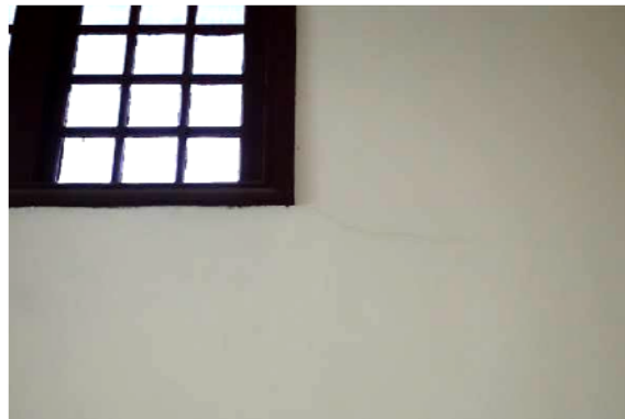
圖 5-32 開口部角隅斜向裂縫
