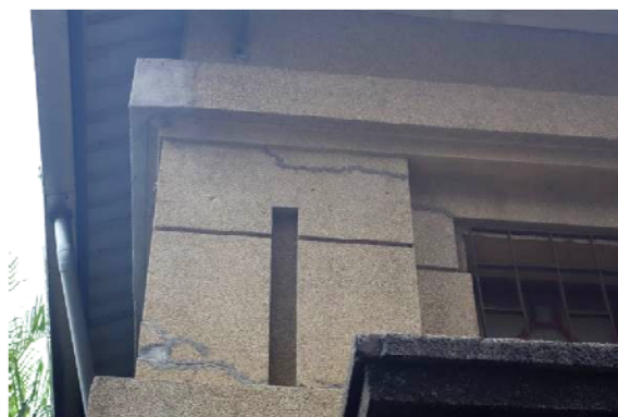
圖 5-34 開口部角隅水平及斜向裂縫
