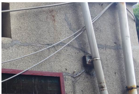
圖 5-21 舊時鐵窗固定鐵件鏽蝕
