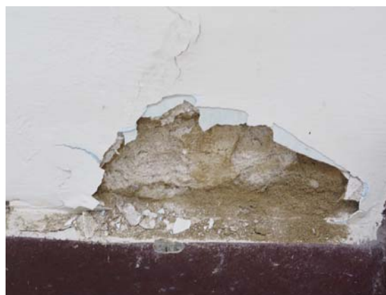
圖 4-23 室內漆喰剝落
