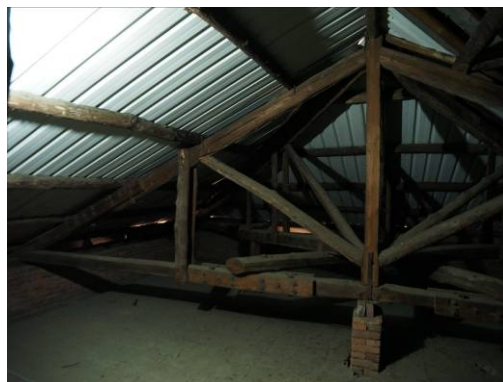
圖 3-124 強行增加磚墩補強
