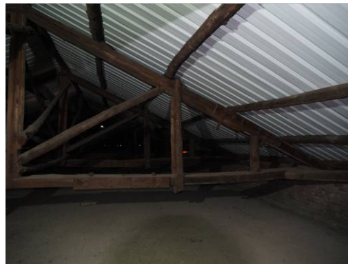
圖 3-122 洋小屋屋架缺少外側方杖（斜稱）
