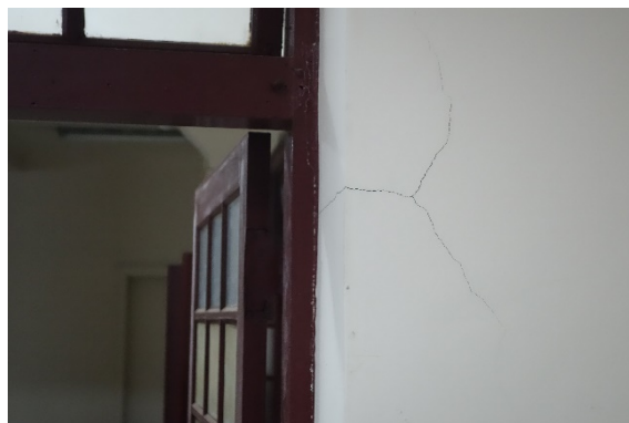
圖 5-20 固定鐵件鏽蝕造成之磚牆裂縫
