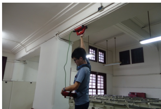
圖 5-57 鋼筋檢測 編號 3：2FL 樑-3
