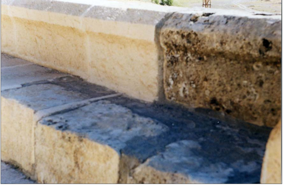
Şekil 4. 8. Cendere Köprüsünde Yanlış Bir Restorasyon Uygulaması
