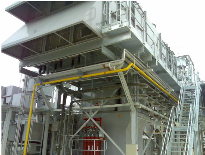
UIPSA CHP plant
