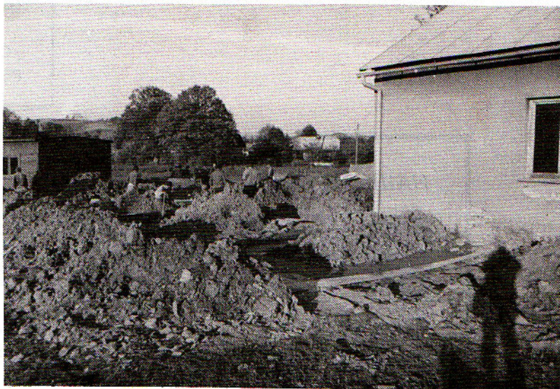
Копання ровів під фундаменти Сільського Дому Культури у с. Мокрому на Лемківщині. Осінь, 1989 р.
