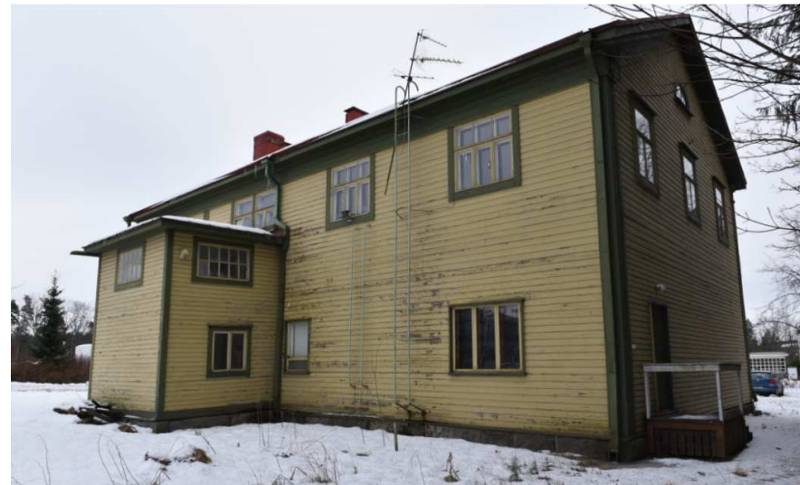
Kuva: Talon tällä sivulla alakerrassa on nyt 50-luvun ikkunat, mutta paikalla oli ennen rungon sisäpuolinen lasiveranta. 50-luvun ikkunoiden kehys on tehty kapeilla syvillä listoilla vuorilautojen sijaan. Porrashuoneessa pikkuruutuisten ikkunoiden saranat ovat yläreunassa.
