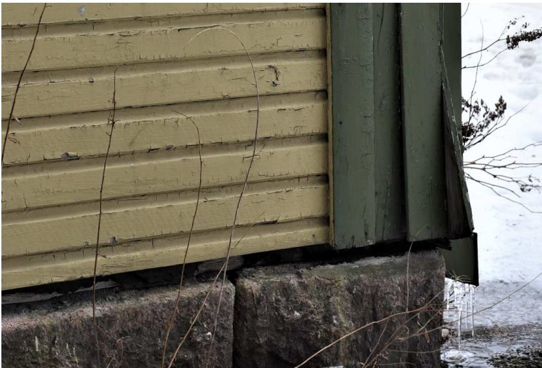
Kuva: Nurkkapilasteri ja avosaumainen ponttilauta. Jalkalista on irronnut.
