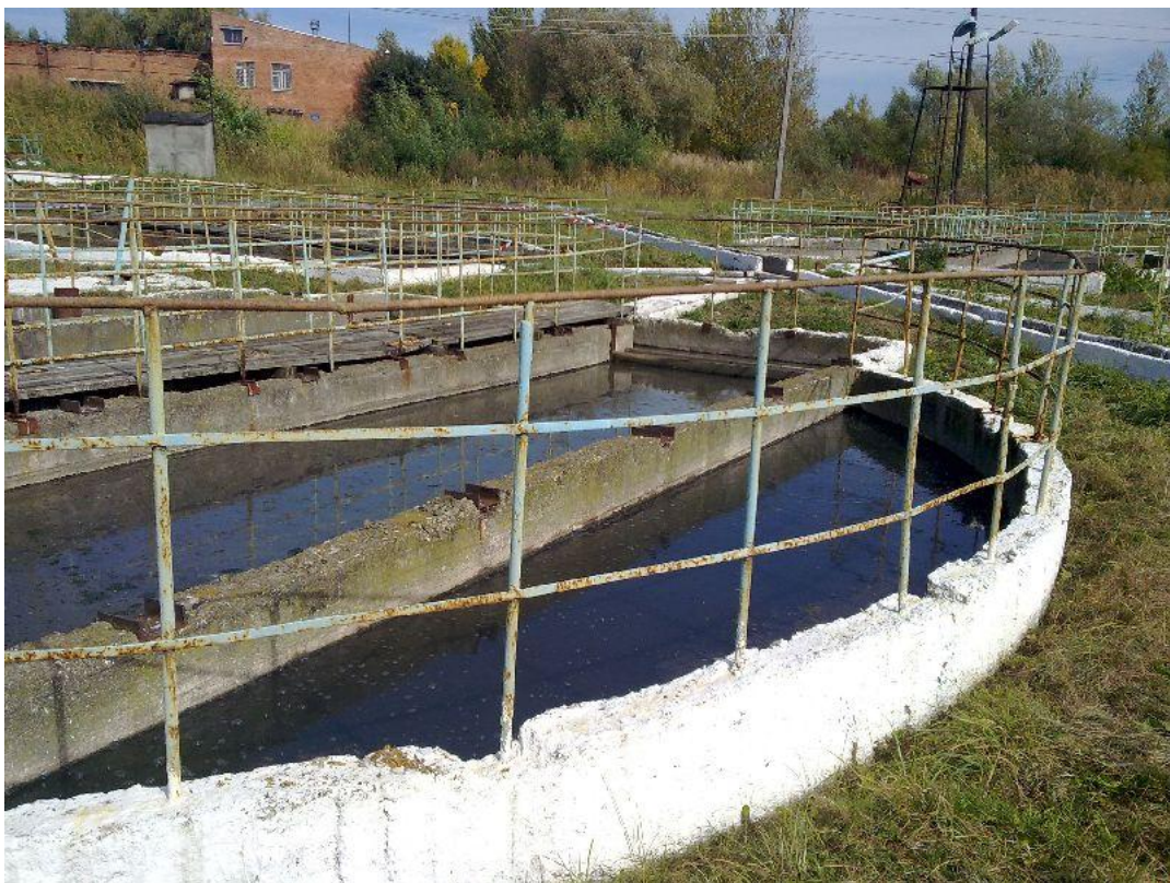
Очисні споруди м.Новий Розділ
