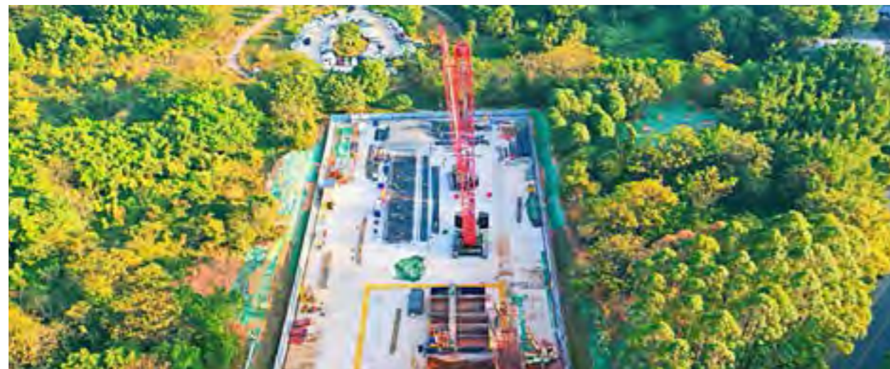
十二号线大学城南至大学城北区间的中间风井 Intermediate air shaft of Higher Education Mega Center S.– Higher Education Mega Center N. Section of Line 12
