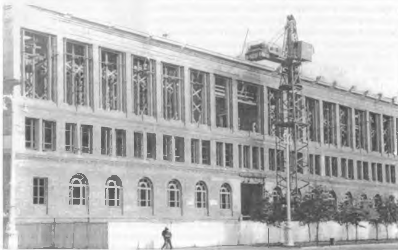
Строительство нового учебного корпуса БГОИФК на Ленинском проспекте Минска (нач. 60-х гг.)
