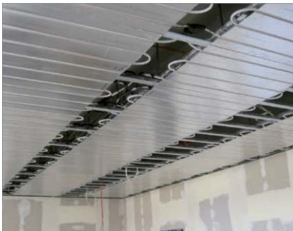
Figura 93. Doble función: calefacción y refrigeración en la zona del techo
