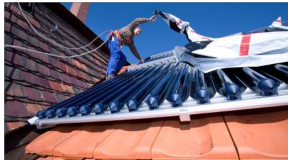
Figura 62. Ejemplo instalacion tubos de vacío
