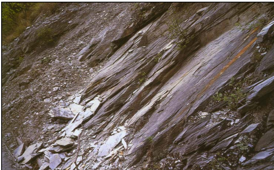
板岩劈理及岩板脫落之情形
