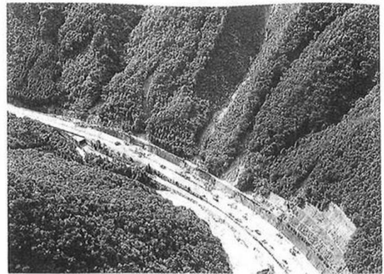
圖 6.98 「中國自動車道」受災狀況（0 級序谷與道路本線以挖方交會的情況，最難實施對策工程） 21)
