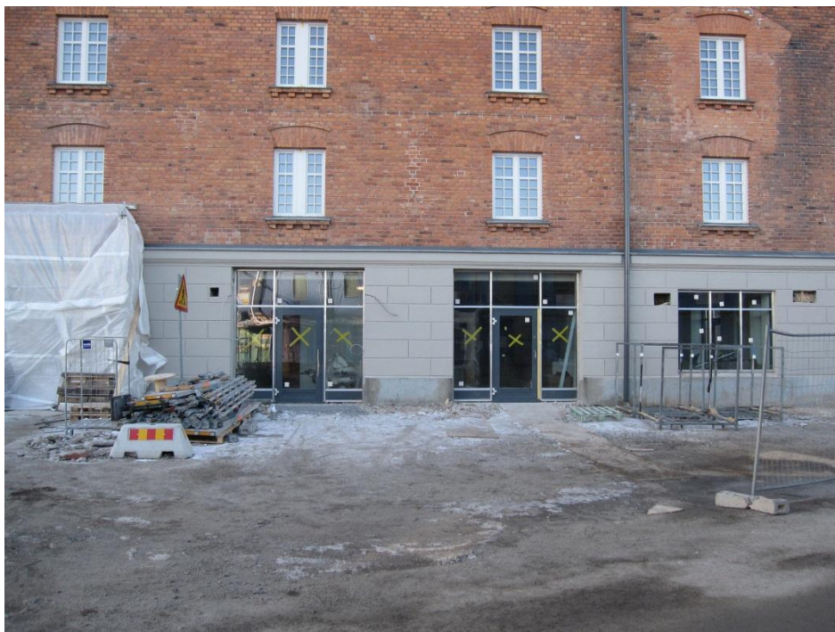
TVå utbytta portar och ett nytt fönster i samma fasad som ovan.
