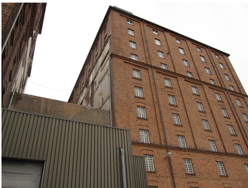
Samma vy, innan rivningen av den sammanlänkande byggnaden mot Magasin 1 var helt utförd.
