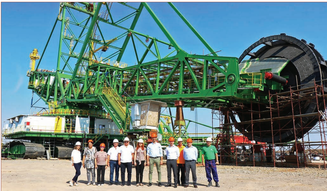
Делегацията, инспектираща изграждането на новите роторни багери в „Мини Марица-изток“ на монтажната площадка и ...
