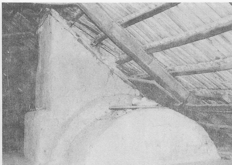
14. ábra Erdő u. 9. sz. ház szabadkéménye. H. Csukás Györgyi felvétele, 1987. Free chimney in the Erdő St. 18.
