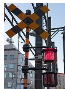
△全方向型踏切せん光灯
