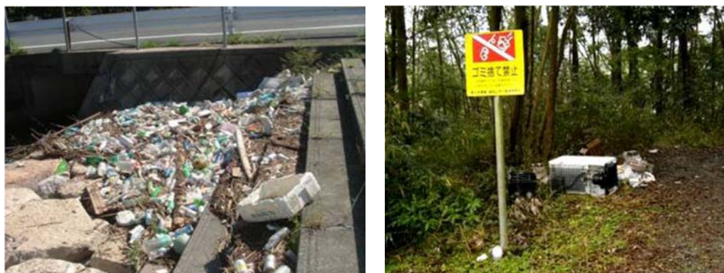
写真 2.4.7 河川区域内のゴミの状況
