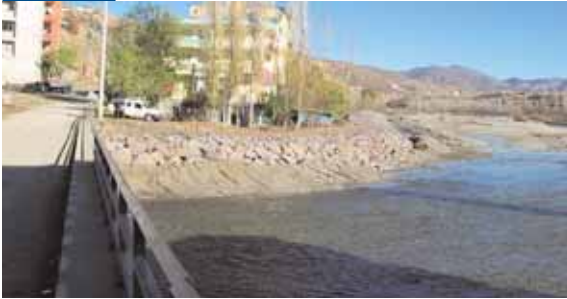
Giresun Alucra Çamoluk Doluntaş Taşkın Koruma Tesisi: Tesis ile 3 adet köy ve 100 hektar arazinin taşkınlardan korunması sağlandı.
