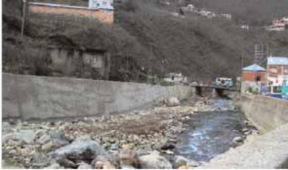
Giresun Merkez Çaldağ Taşkın Koruma Tesisi: Tesisle 1 kasabanın taşkınlardan korunması sağlandı.
