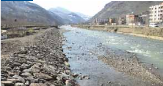
Trabzon Merkez Değirmendere Taşkın Koruma Tesisi: Tesisle il merkezinde Değirmendere üzerinde kalan yerleşim birimlerinin taşkınlardan korunması sağlandı.
