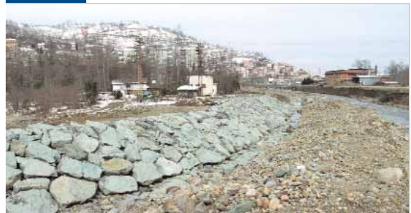
Trabzon Sürmene Yokuşbaşı Taşkın Koruma Tesisi: Tesis ile 1 köyün taşkınlardan korunması sağlandı.
