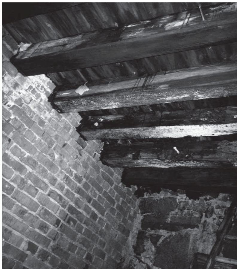
Bjälklaget är fuktskadat och svampangripet. Foto författarna, 2000.
