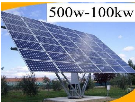
Gambar 1: Pembangkit Listrik Tenaga Surya
