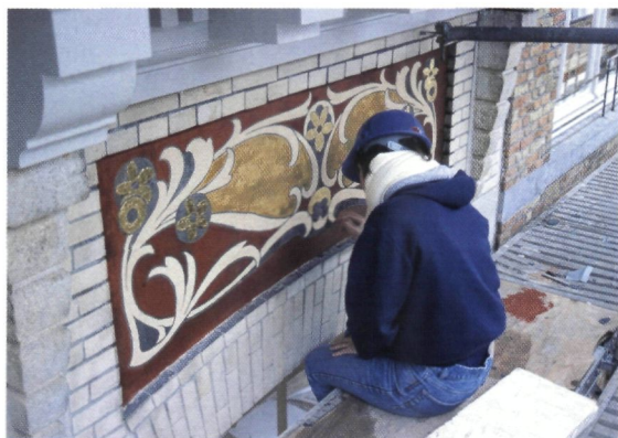
▲ Restauratie van de sgraffiti door studenten van de Opleiding Conservatie/Restauratie (foto Karin Keutgens)
