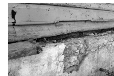
Veelaua puudumisest põhjustatud soklikahjustus. (Foto: M. Loit)
