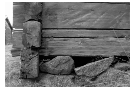
Veidi vajunud taluhoone vundament. (Foto: M. Loit)
