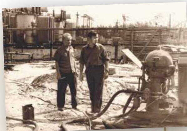
Начальник Дирекции строящихся нефтепроводов И. Л. Кухта (слева) на строительстве первой нефтенасосной Староликеевской НПС
