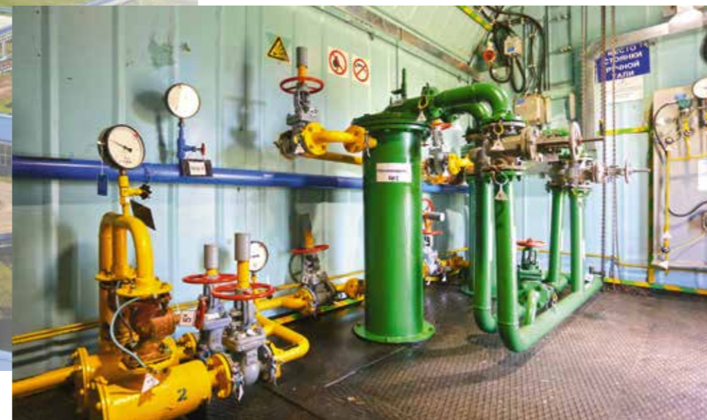
Система маслоснабжения, НПС «Мостовая»
