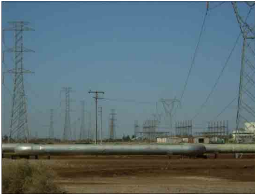
Figura IV.36. Vista parcial de la infraestructura instalada y observada en el campo geotérmico
