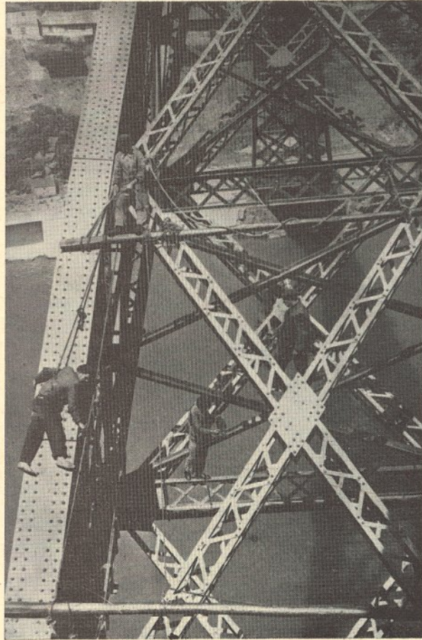
Como trabalha o pessoal da Via e Obras — Pintura geral da Ponte Maria Pia, do lado de Gaia — (Foto do sr. Armando Ricco, Insp. do Serv. de Obras Metálicas)
