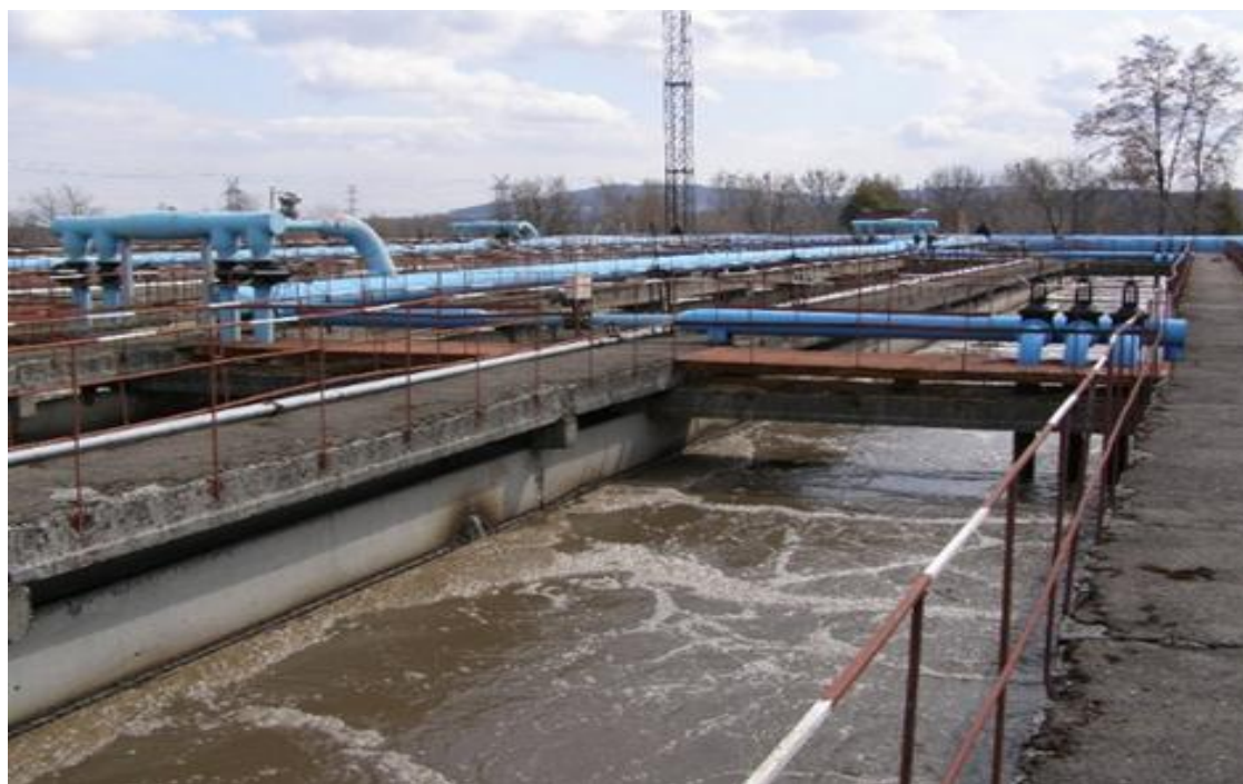
Очисні споруди ЛМКП «Львівводоканал»
