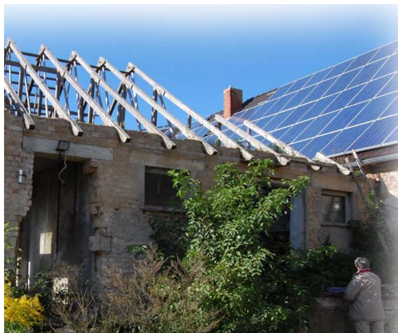
Vanhan käytöstä poistuneen maatilarakennuksen katolle on asennettu aurinkopaneeleita. Esimerkki Saksasta. (Kuva Emilia Rönkkö).
