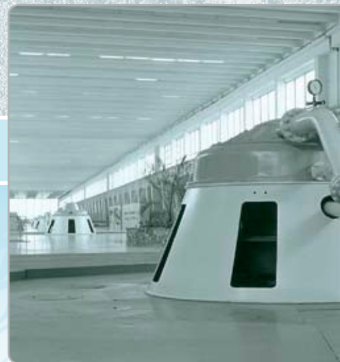
Машинный зал. Саратовская ГЭС
