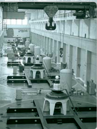
Машинный зал. Новосибирская ГЭС
