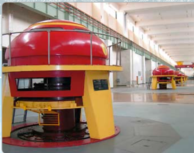
Машинный зал. Чебоксарская ГЭС
