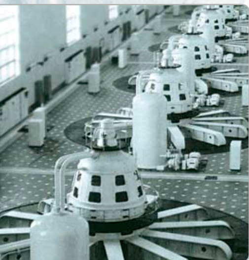
Машинный зал. Иркутская ГЭС
