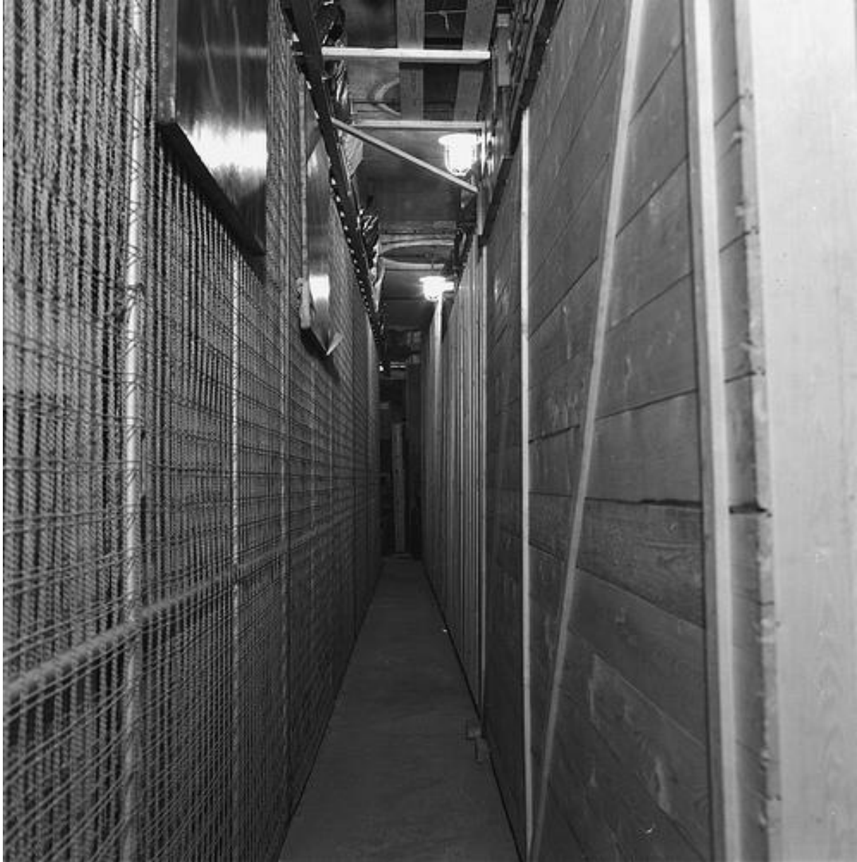
Figuur 15: Een gedeelte van het rekkensysteem in de Kluis
