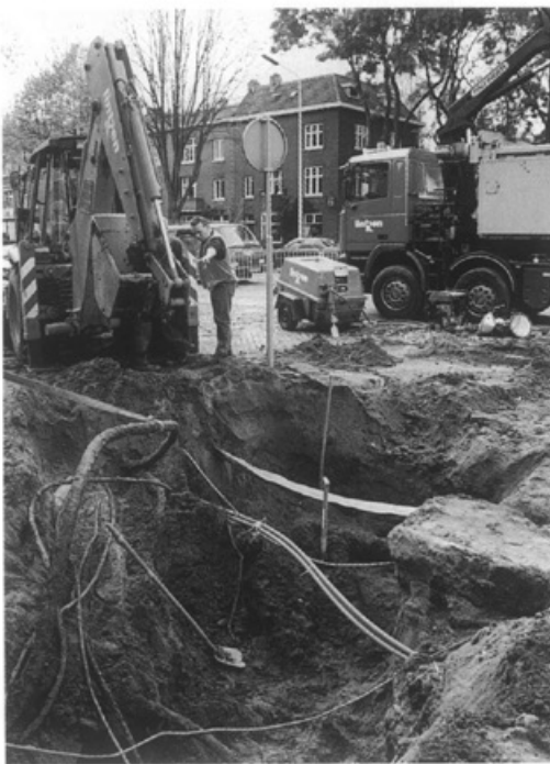
Een breuk in de waterleiding slaat op 8 november een enorm gat in de Hertogsingel • Foto Focuss 22
