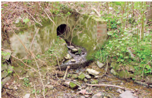
Abb. 3.1.5-3 Verrohrung im Stei- nendorfer Bach (Nebengewässer des Nacker Baches) (Quelle: Planungsbüro Koenzen)
