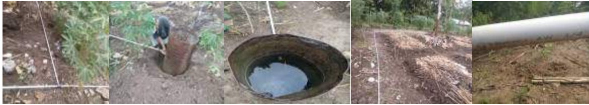
Gambar 8. Instalasi perpipaan untuk irigasi Penerapan bingkai A dan pengolahan lahan terasering
