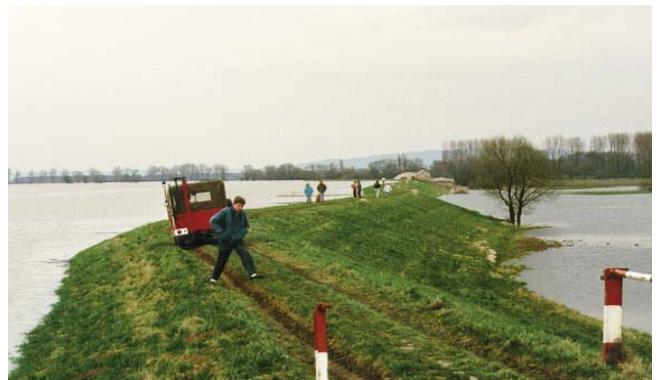
Abb. 73: Das Befahren oder Begehen der Deiche und deren Böschungen führt schnell zu einer Schwächung der Standsicherheit und sollte möglichst vermieden werden.
