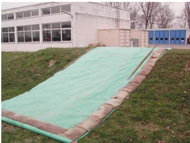
Abb. 57: Foliensicherungen eignen sich nur für die Abdichtung lokal begrenzter Beschädigungen auf der wasserseitigen Böschung. Die Abbildung zeigt ein bei einer Übung zur Deichverteidigung eingesetztes Lecksegel, das auf der Deichkrone fixiert ist und über die wasserseitige Böschung abgerollt wurde.
