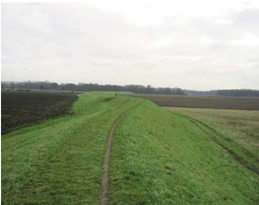
Abb. 13: Nicht ausgebaute Deich bei Erfelden
