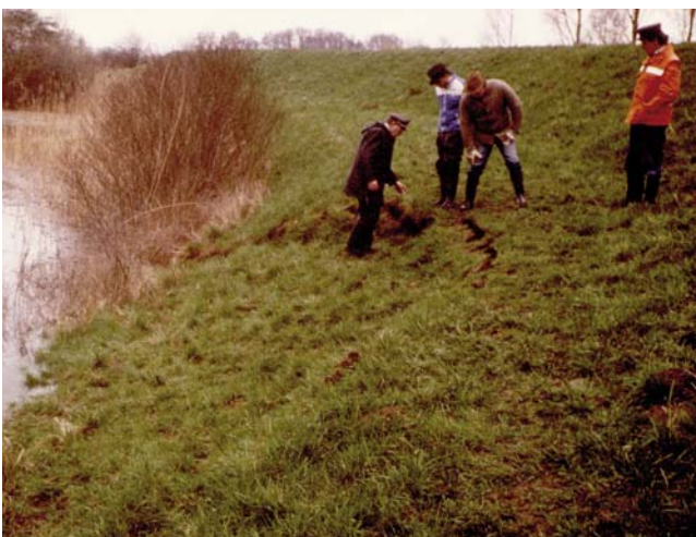
Abb. 34: Risse in der Deichböschung
