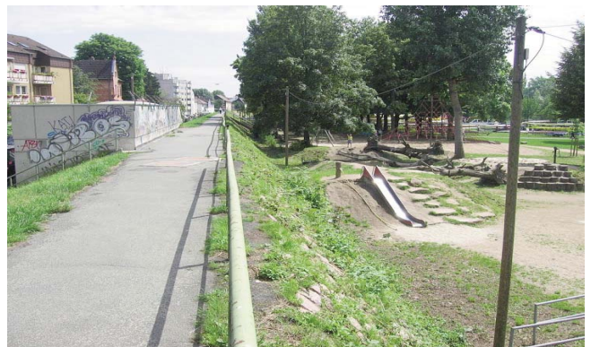
Abb. 74: Zu nahe Bebauung am Deich verhindert die Kontrolle und erhöht bei Einbauten im Untergrund die Durchsickerung. Sickerwasseraustritte werden gar nicht oder zu spät erkannt. Die Deichverteidigung wird erschwert.
