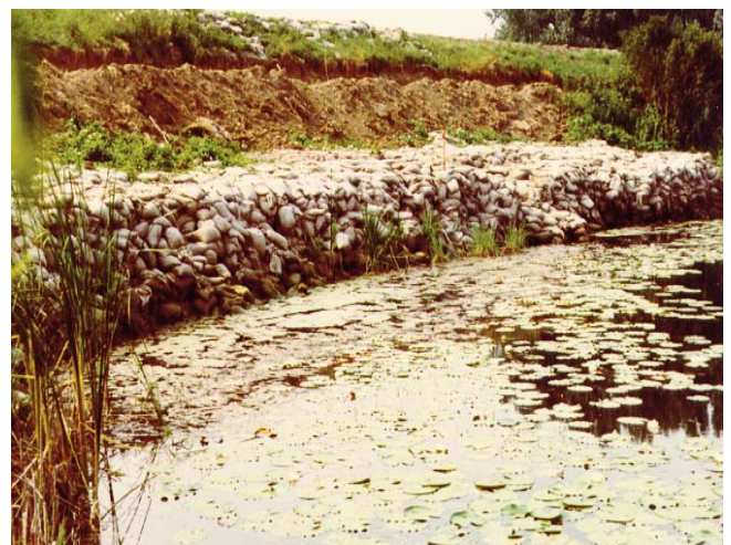
Abb. 35: Rutschung und Böschungssicherung
