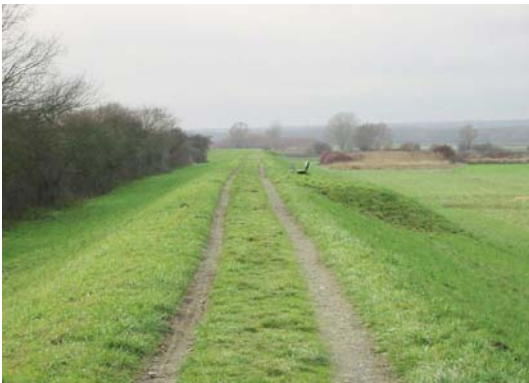
Abb. 12: Nicht ausgebaute Deich bei Erfelden
