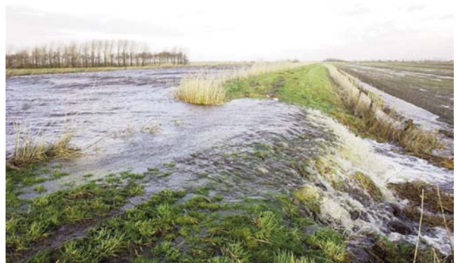
Abb. 38: Überströmung eines ungesicherten Deichs
